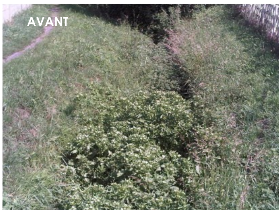
Le Lutiau couvert par trop de végétation
