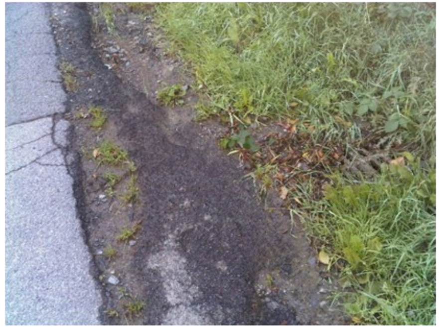
Le puisard des EP rendu inefficace : fossé bouché
